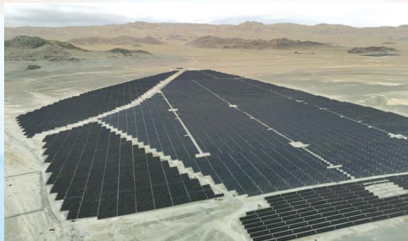
西藏拉果错“零碳提锂”源网荷储示范项目
