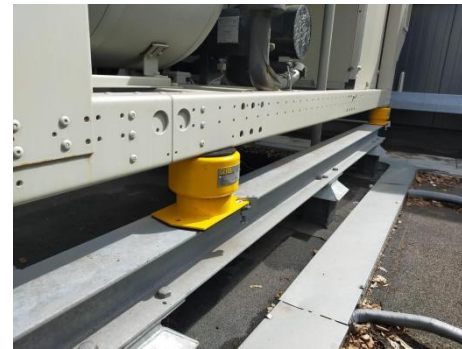
住宅屋面热泵改造后的弹簧隔振支座
