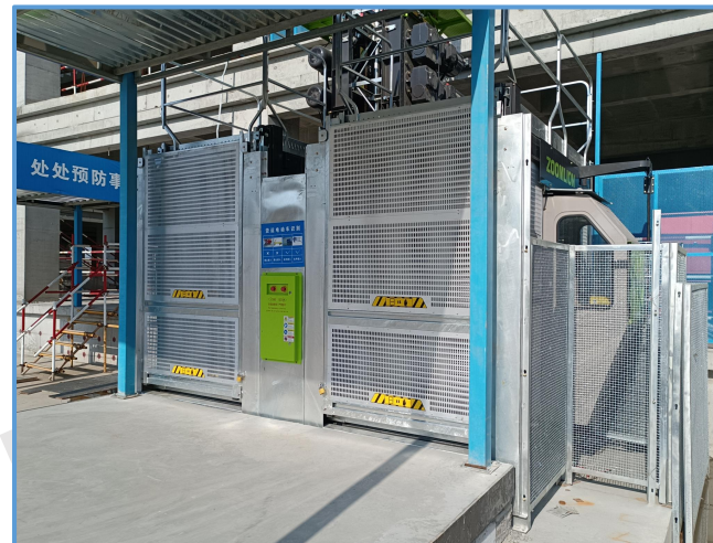
图6-74 施工升降机地面防护围栏
