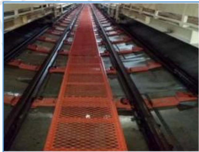
图8-134 隧道内机械设备轨道（2）
