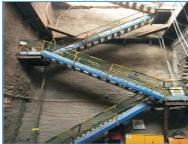
图8-77 竖井下井爬梯
