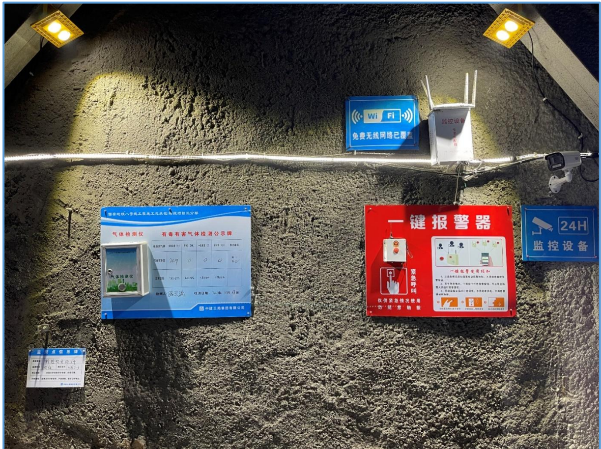
图8-102 隧道内视频监控、无线网基站、气体检测、一键报警器
