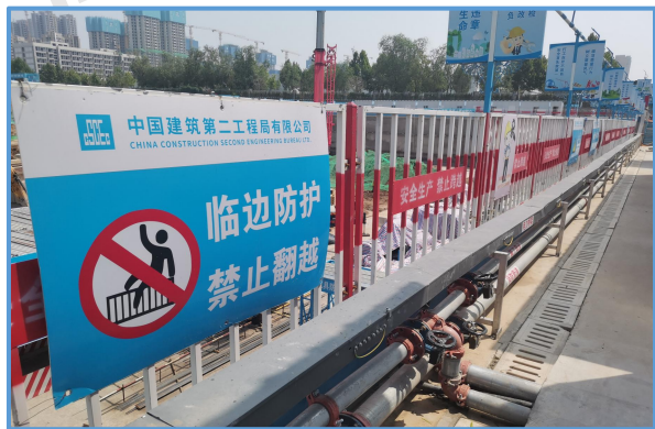
图2-16 基坑临边安全警示标牌
