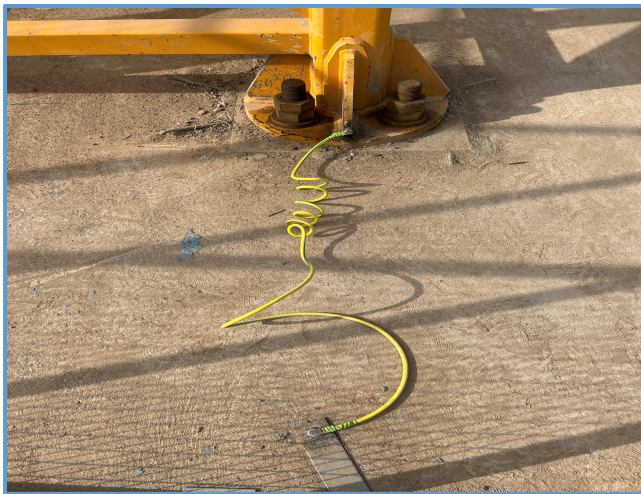
图6-33 塔吊设备接地（电气、防雷）
