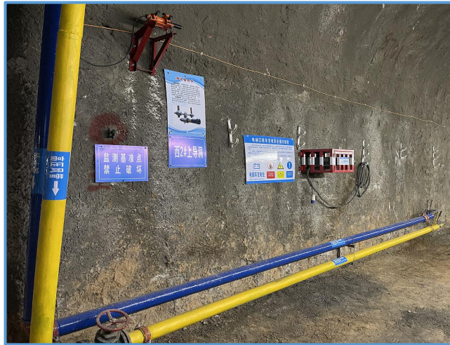
图8-98 隧道高压风、水管布设
