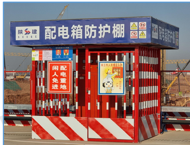
图5-30 配电箱防护棚（2）
