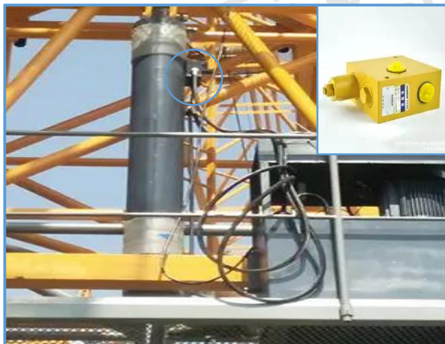
图6-31 塔吊液压油缸平衡阀、液压锁
