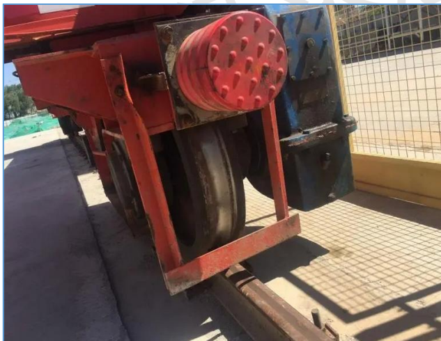
图6-158 龙门吊防碰撞、轨道清扫装置 (1)
