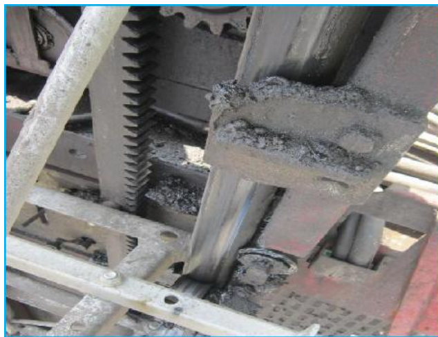
图6-93 施工升降机安全钩
