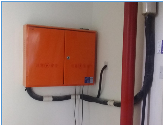
图5-15 楼层墙面设置固定配电箱
