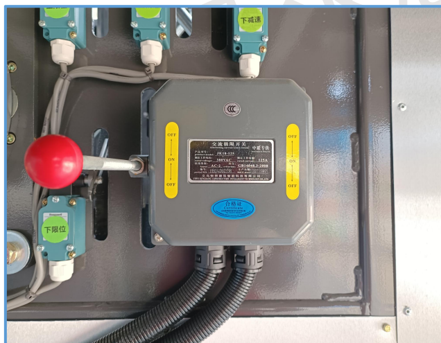
图6-87 施工升降机极限开关
