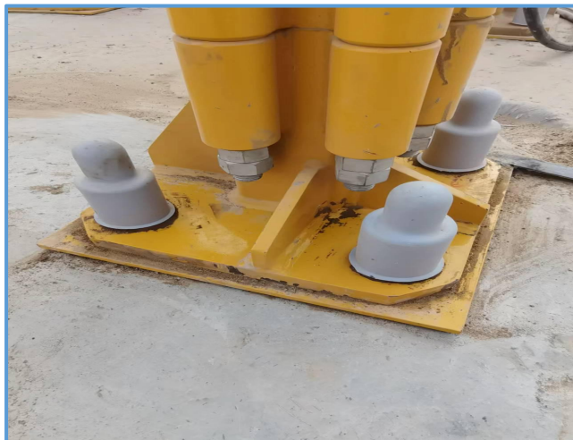
图6-49 塔吊高强度地脚螺栓
