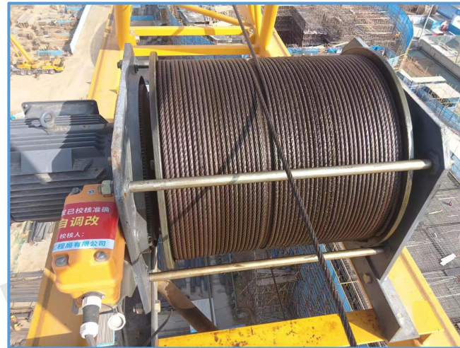
图6-22 塔吊变幅限位器
