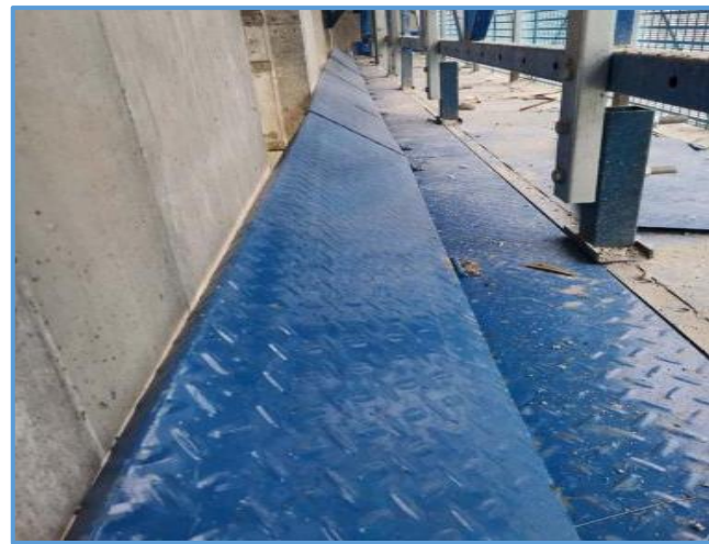
图3-26 架体与结构缝隙处翻板
