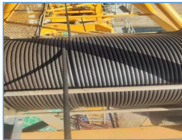
图6-48 塔吊小车卷筒绳槽
