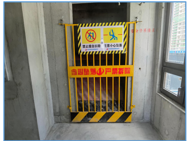
图9-67 临边洞口安全警示风险语音提示
