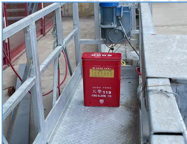
图3-40 吊篮操作平台灭火器设置
