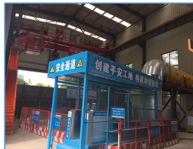
图8-81 井口通道安全防护棚
