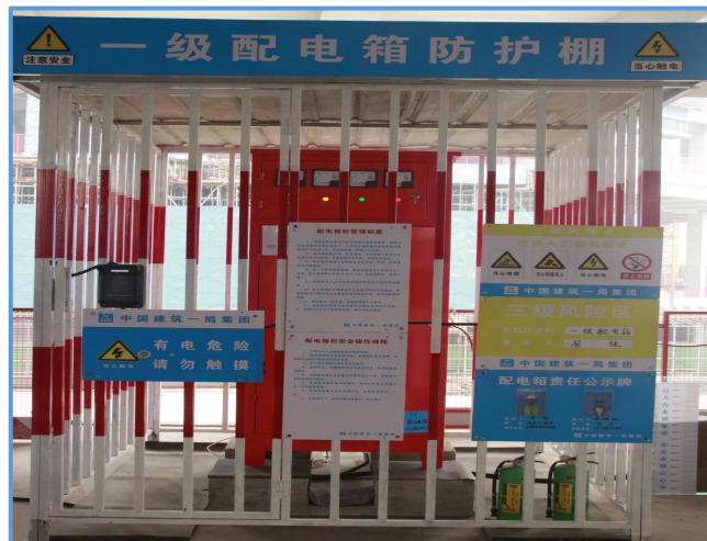
图5-30 配电箱防护棚（1）
