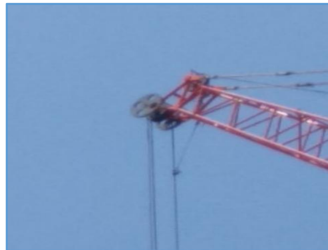
图6-145 履带吊高度限位器有效
