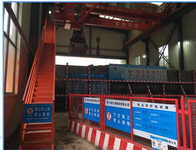
图8-79 竖井口临边防护（2）
