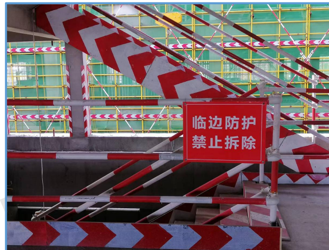
图7-38 楼梯临边防护（2）
