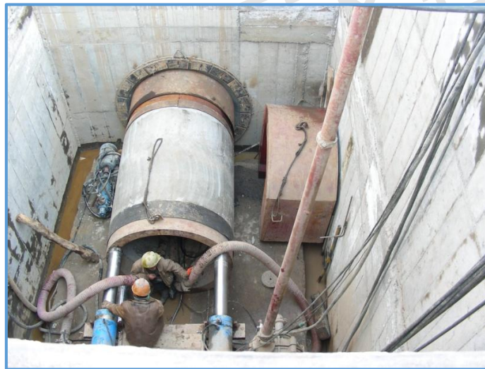
图8-36 洞口止水装置
