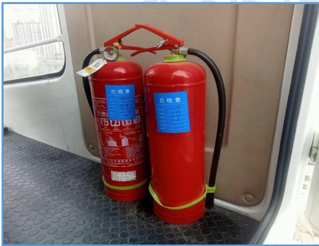
图6-59 塔吊驾驶室灭火器
