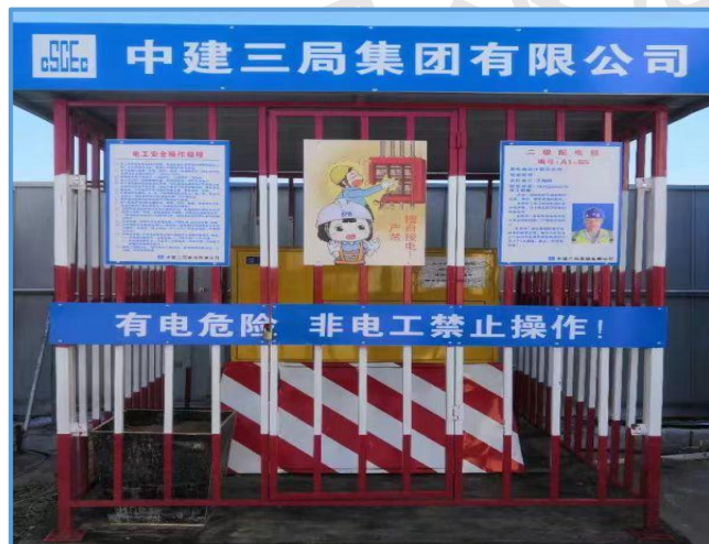
图5-30 配电箱防护棚（3）
