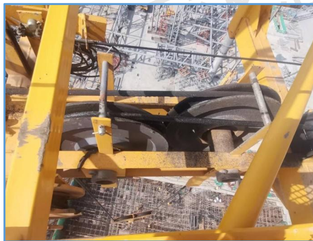
图6-27 塔吊钢丝绳防脱槽保险
