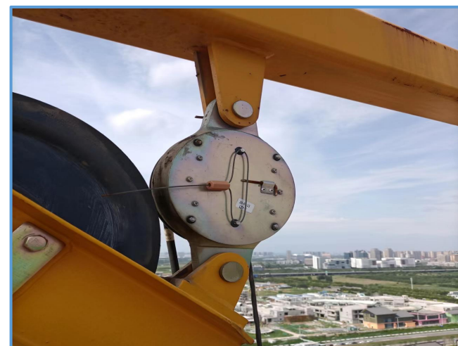
图6-24 塔吊起重量限制器
