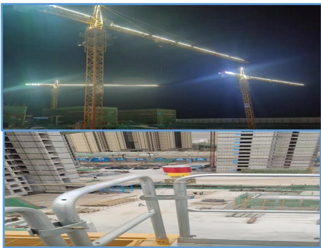
图6-60 塔吊障碍灯、灯带
