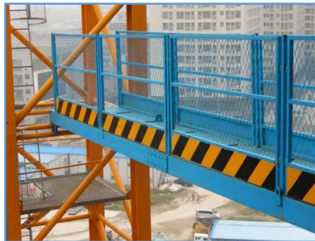
图6-52 塔吊上人通道
