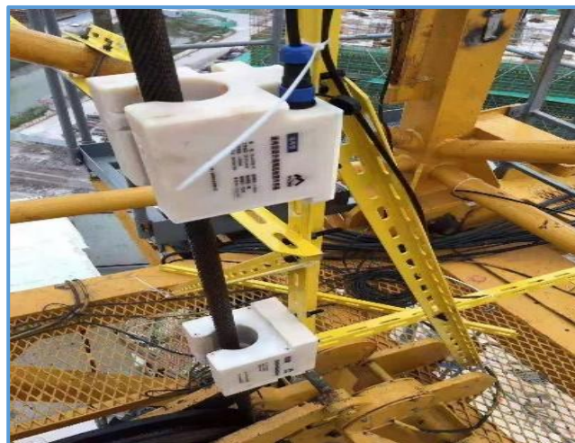
图9-51 钢丝绳监控系统（1）
