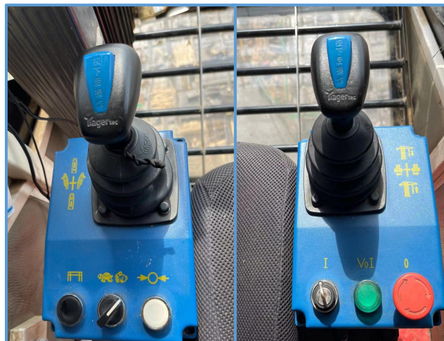
图6-32 塔吊操作手柄零位按钮、急停按钮
