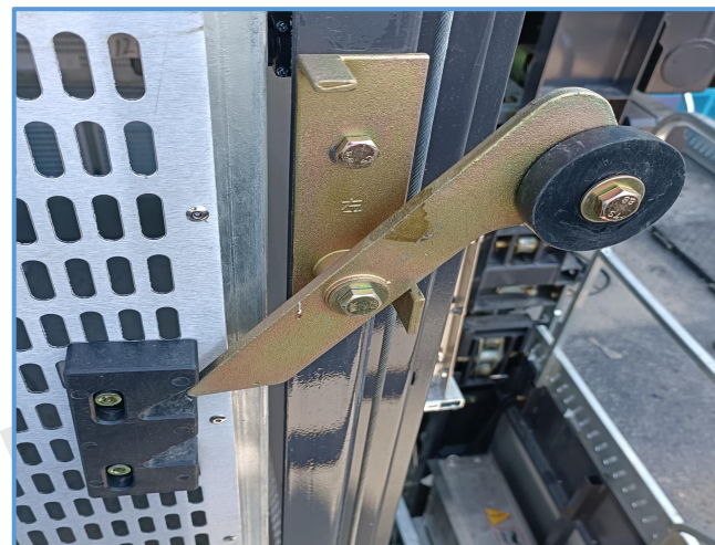
图6-82 施工升降机吊笼门机械联锁
