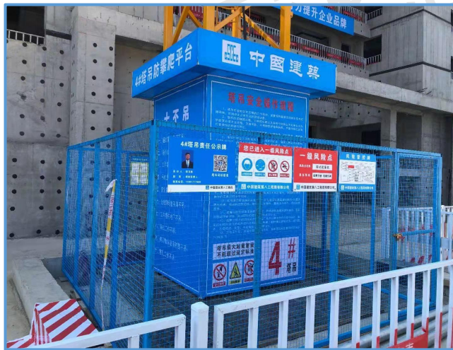
图6-19 塔吊防攀爬装置（A和B同时使用）
