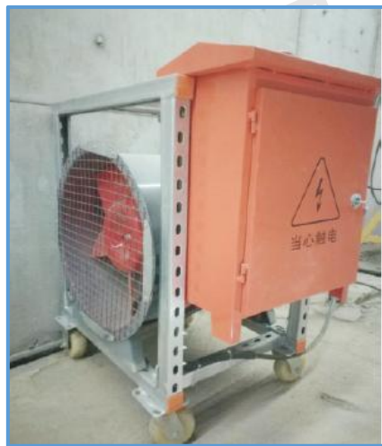
图7-85 通风换气设施
