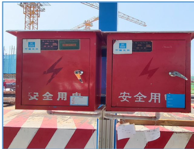
图5-26 配电箱进出线
