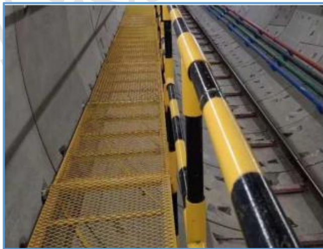
图8-131 隧道内走道板（2）
