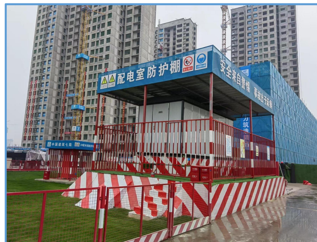
图5-30 配电箱防护棚（4）
