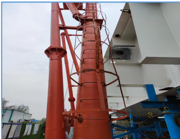
图6-166 龙门吊上下通道
