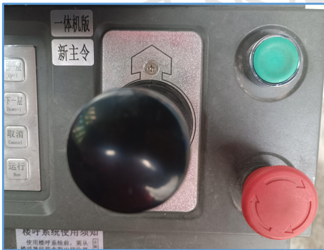
图6-103 施工升降机急停开关
