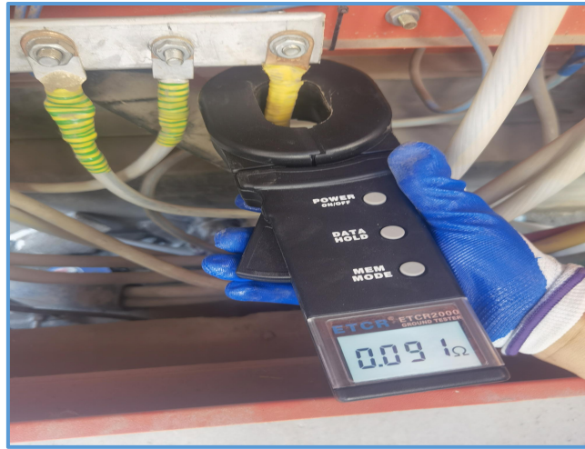
图5-34 电阻测试仪测试接地电阻
