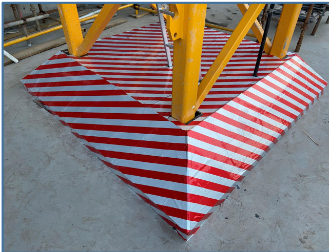
图6-53 塔吊预留洞口防护
