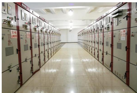
正常照明和应急照明
