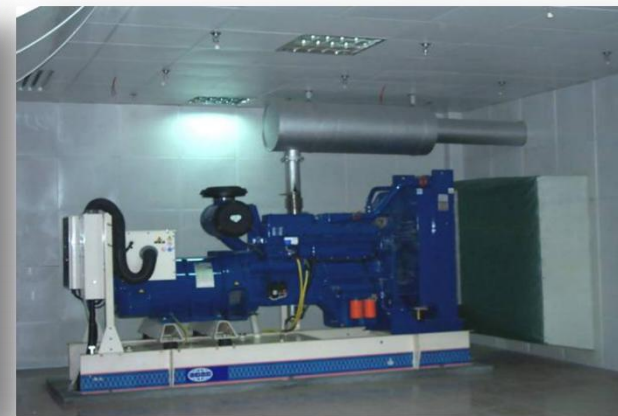
发电机排烟管道
