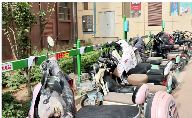
电动自行车充电设施
