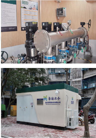
图4 新建社区叠压泵房
