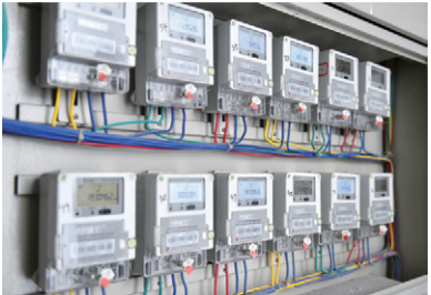
图11 供电“一户一表”改造
