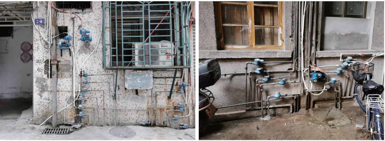
图3 小水泵存在安全隐患
