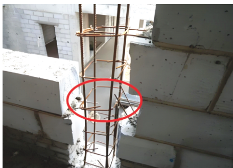
拉结筋与构造柱锚固不规范
