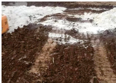
灰土未拌合均匀
