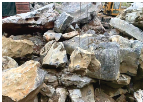
石制假山山体沉降、裂缝
