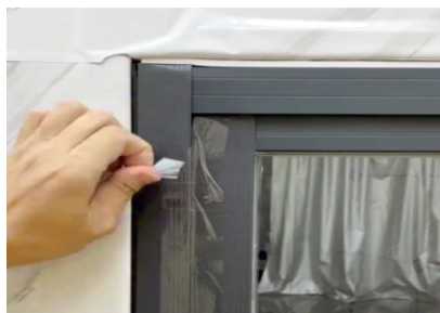
外窗气密性差、噪音过大
