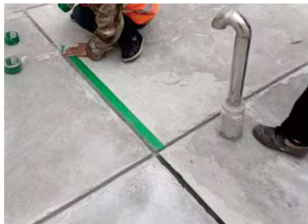
屋面明设排气管留设质量问题
