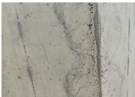
混凝土蜂窝麻面
