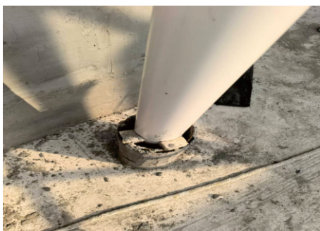
出屋面管道处理不到位渗水
