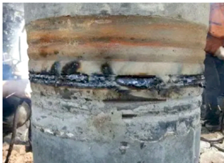
管桩接头焊接缺陷
