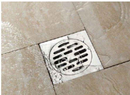
地漏排水不畅
