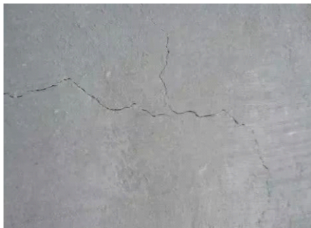
砂浆面层开裂、空鼓、脱落
