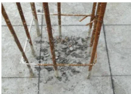
钢筋施工偏位
