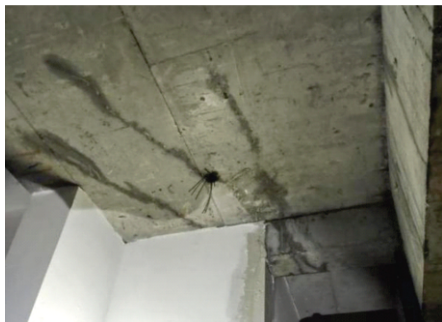
地下室顶板开裂渗漏
