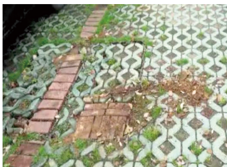
停车场植草砖沉陷、积水
