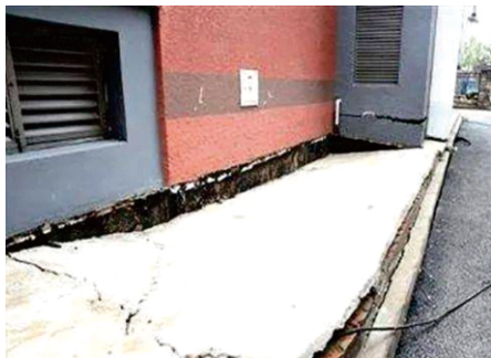
回填土下沉、塌陷
