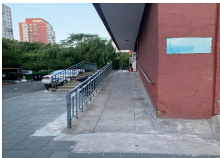
无障碍坡道、扶手安装不符合要求
