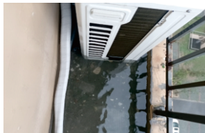
未设置导流槽渗漏
