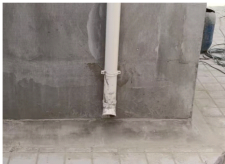
落水管下未安装水簸箕
