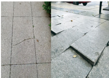
石材铺贴空鼓、断裂
