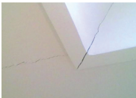
吊顶转角开裂
