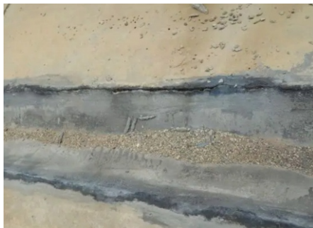
屋面天沟排水不畅
