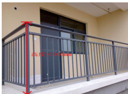
栏杆高度不足
