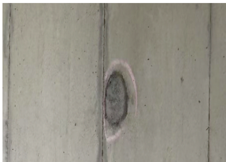
外墙螺杆洞渗漏
