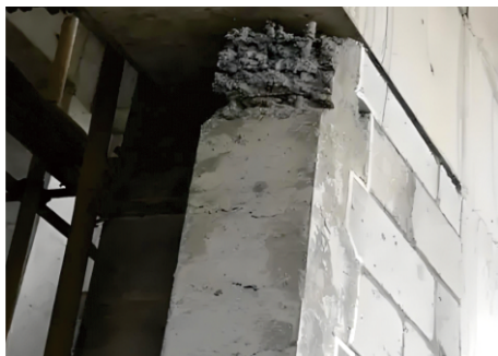
构造柱顶部不密实
