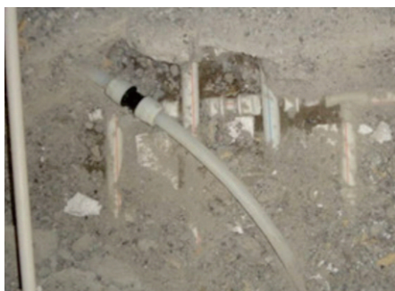
地辐热管道漏水
