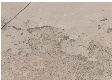
细石混凝土保护层开裂
