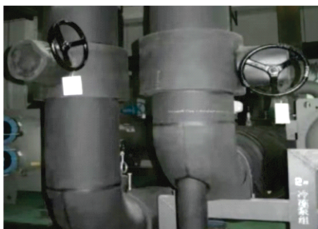
管道防腐保温影响使用功能
