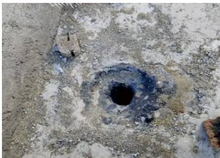
屋面水落口渗漏
