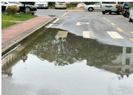
道路排水沟、路面存在积水、排水不畅
