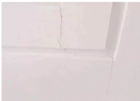
吊顶变形开裂
