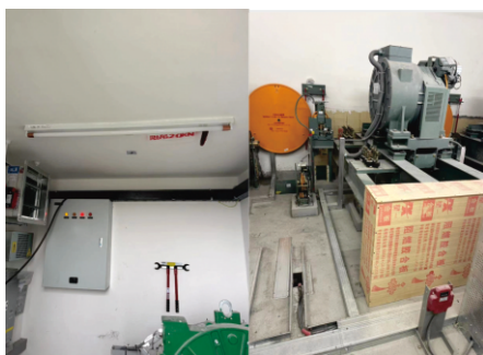
灯具在曳引机上方，接地失效
