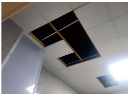
吊顶变形脱落
