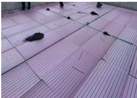
板状材料保温层铺设质量问题
