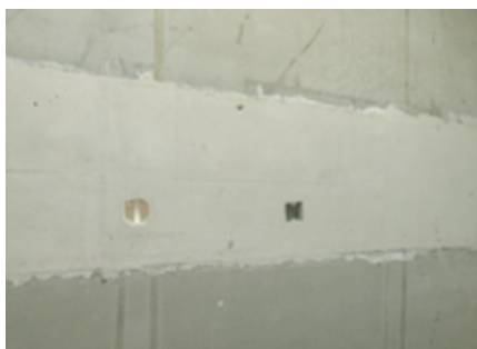
叠合板错台、漏浆
