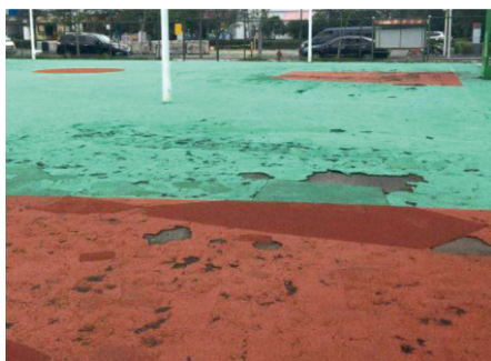
EPDM橡胶颗粒地面脱皮、开裂、鼓包
