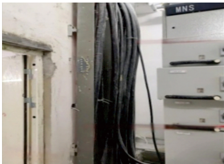
桥架内敷线存在缺陷
