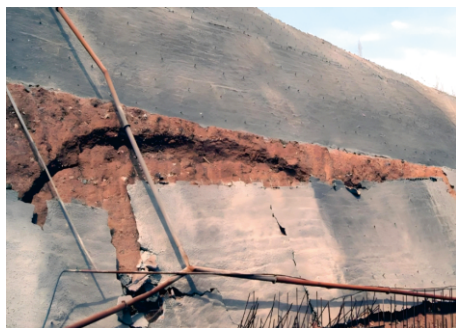
土钉墙支护面层开裂脱落
