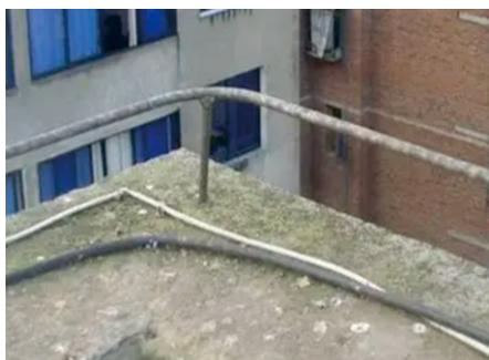
屋面接地安装缺陷
