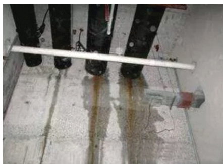
穿墙套管渗漏
