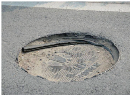
道路井盖周边沉降、突起
