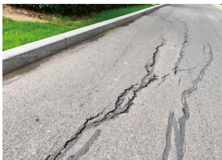
沥青路面裂缝
