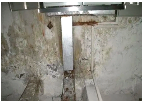
屋面变形缝渗漏
