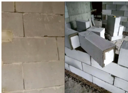
砖缝不饱满、灰缝不均匀
