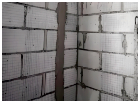
圈梁、构造柱、角柱缺失
