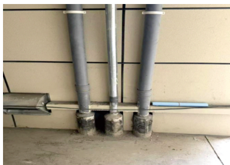
排水管道透气管施工错误
