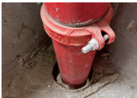
套管高度不足未封堵
