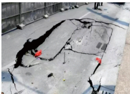
基坑周边地面沉降
