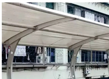
膜结构车棚膜面松弛、撕裂
