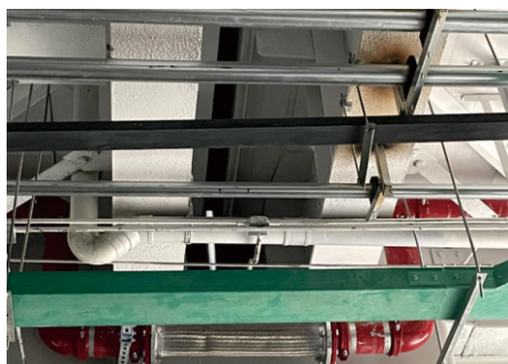
管线穿越变形缝未采取抗变形措施
