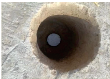
水泥粉煤灰碎石桩断桩
