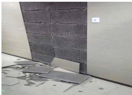
室内墙面贴砖空鼓、脱落
