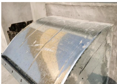
室外风管穿墙漏水
