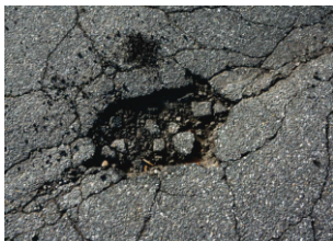
沥青路面起皮、脱落
