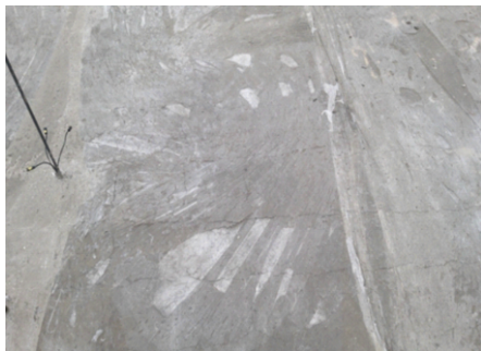
大体积混凝土冷缝、裂缝
