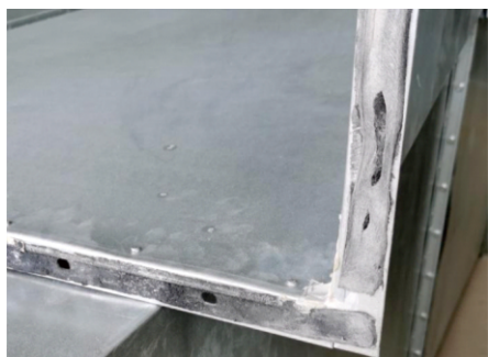
风管密封不严漏风严重
