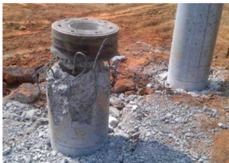
管桩桩头碎裂
