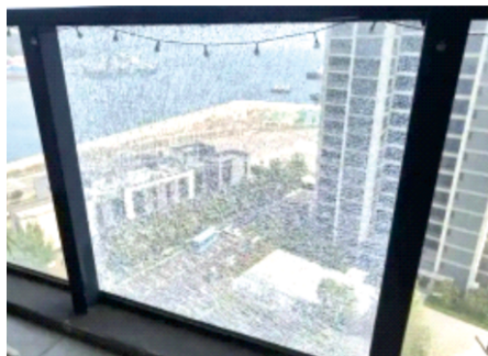
玻璃栏杆玻璃爆裂
