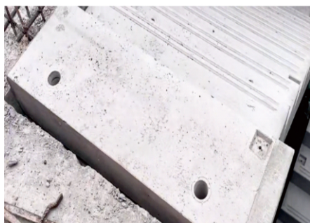
预制楼梯安装标高有误
