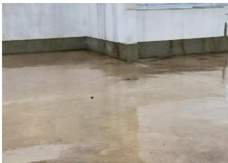
找坡层坡度、坡向不准确
