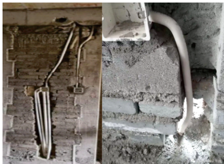
二次配管不规范破坏墙体
