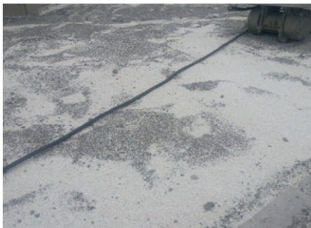
现浇泡沫混凝土保温层疏松、开裂
