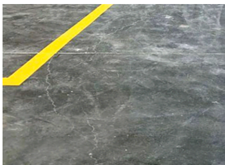
金刚砂地坪开裂
