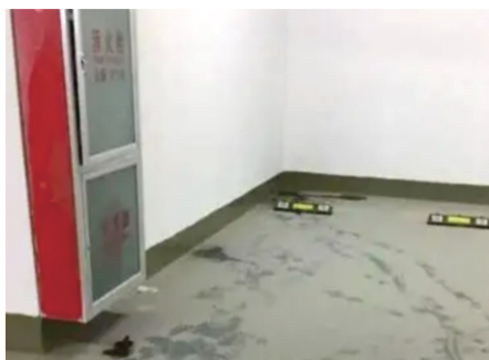
消火栓被遮挡
