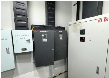
应急照明配电箱未采用下进线
